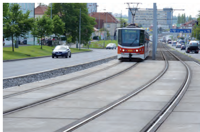
Praha - Hloubětín zákrytové desky SILENT®
