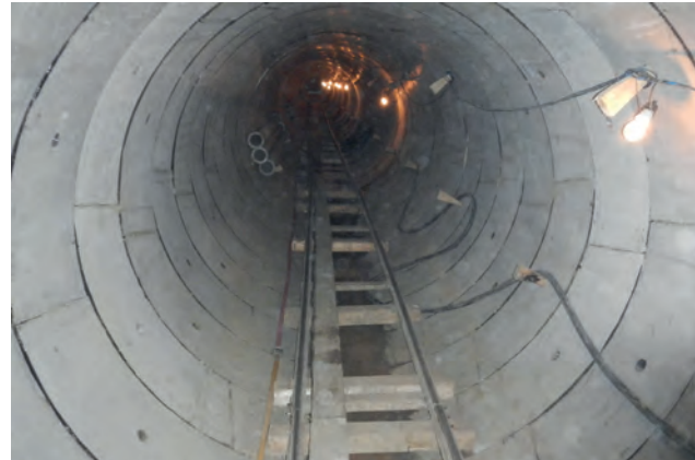
nespojované železobetonové segmenty štol
