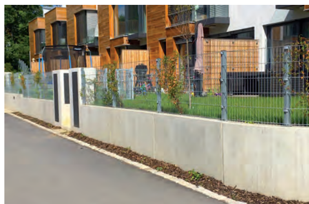
Šárecké údolí opěrná stěna
